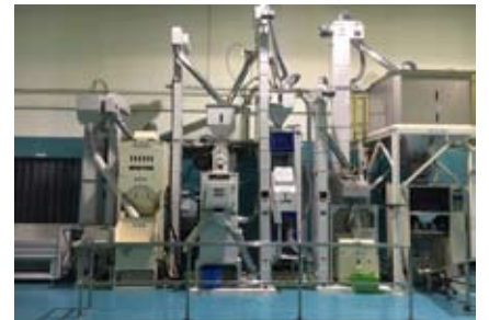
シンガポール精米設備
